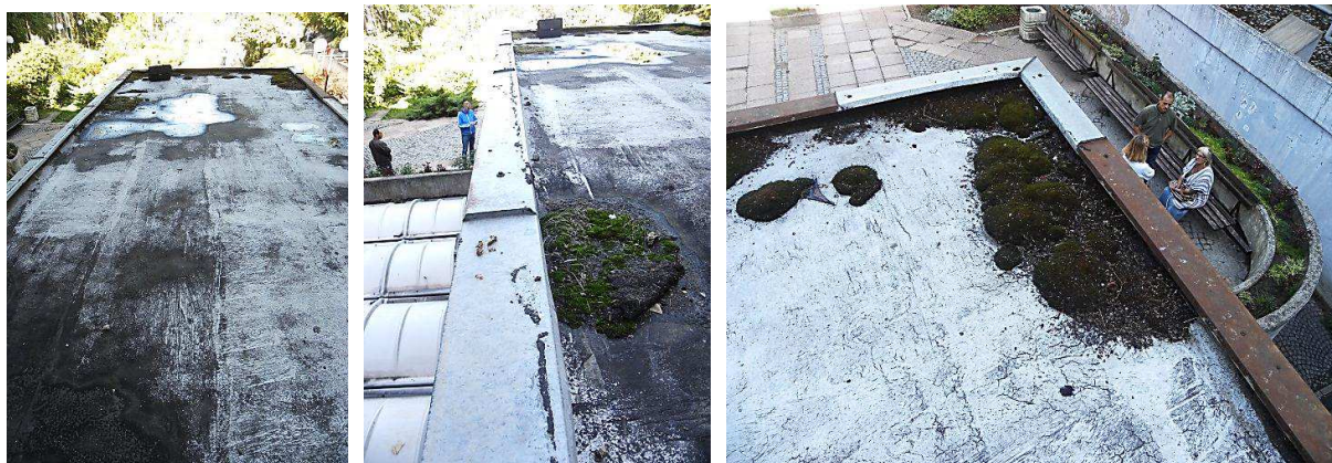
Izgledi oštećenja i patine ravnog krova iznad ulaznog vetrobrana
